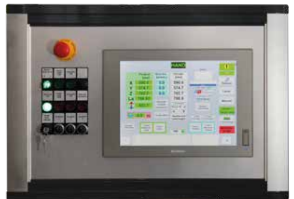
Steuerung Control Panel
